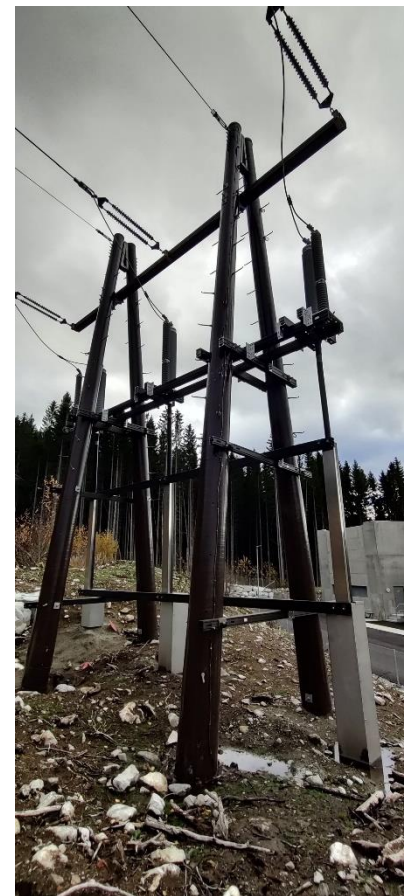
2A-mast montert på fjell i Kaupanger
